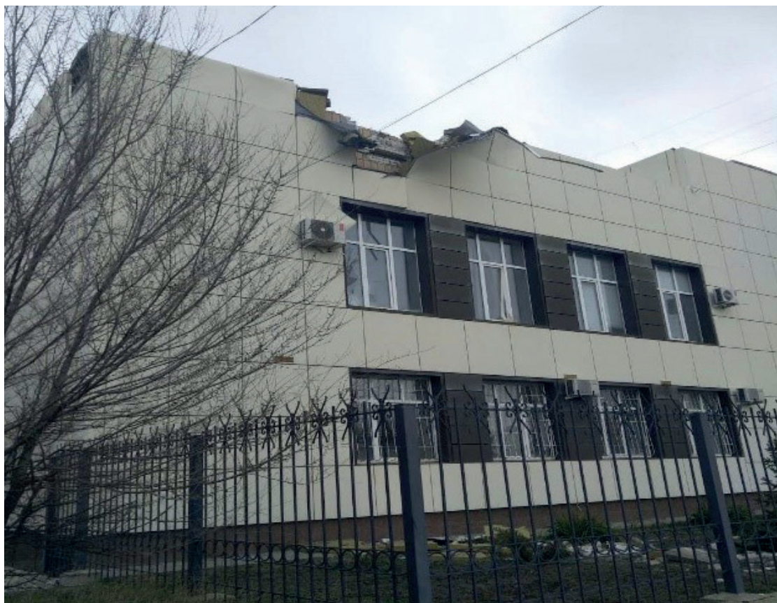
Пошкоджена будівля Луганського окружного адміністративного суду
